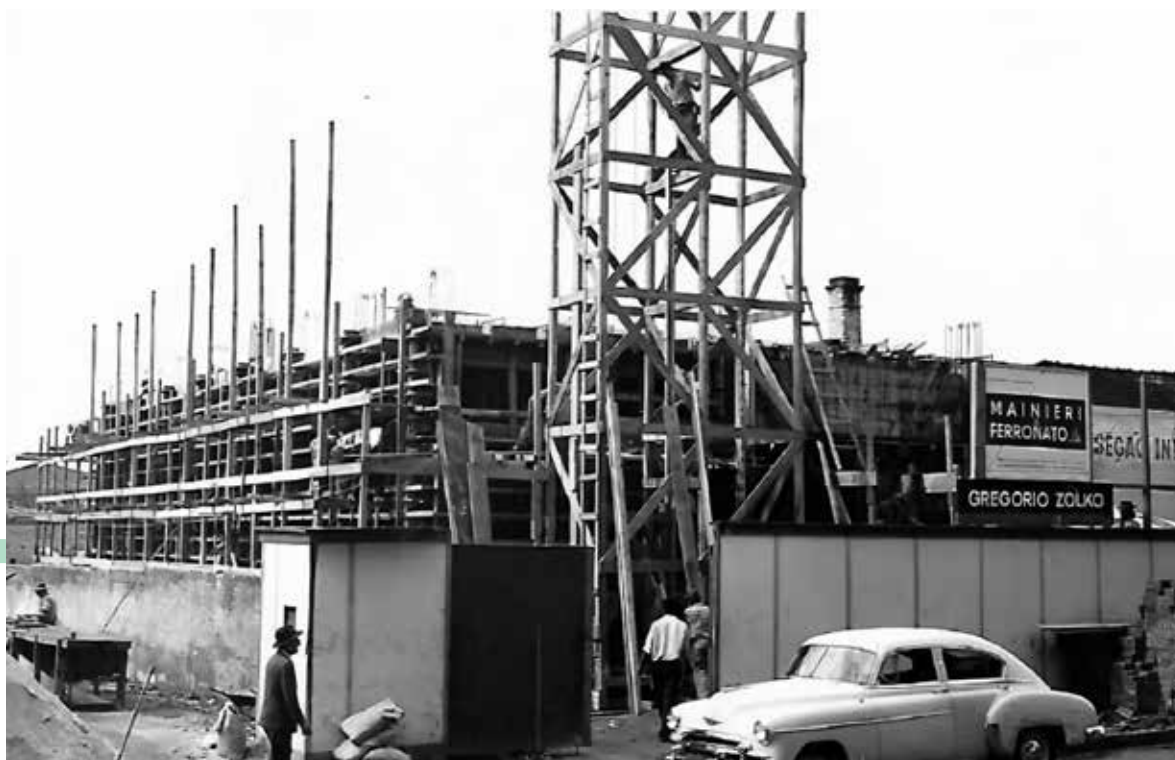
Obras de fundação do edifício-sede das Emissoras Associadas no bairro do Sumaré, realizadas a partir de março de 1959 (Acervo Família Mainieri).
